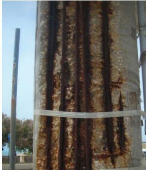
Palo in cemento armato con ferri corrosi
